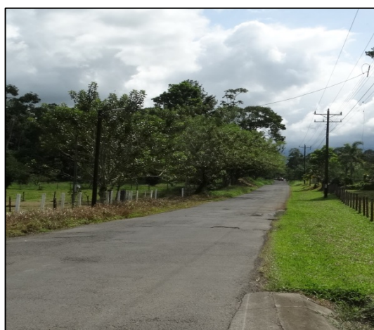
Figura N° 4. Ruta Nacional con grietas y baches
