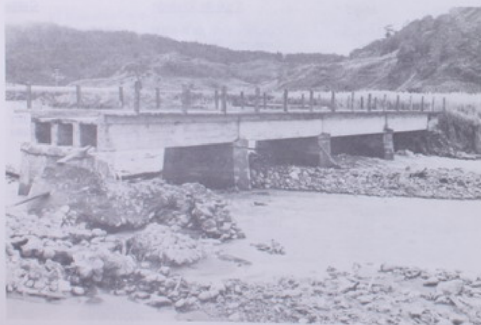
Daños causados por los temporales
