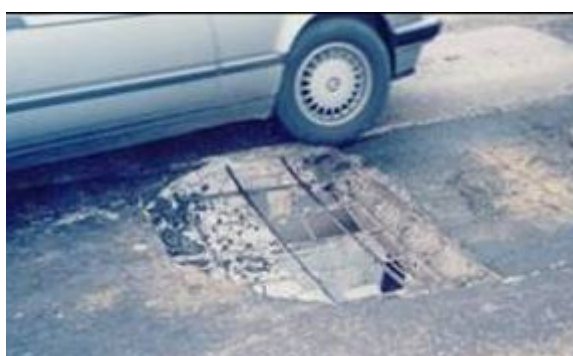
Figura 6-19 Agujero en la losa (grado 5)
