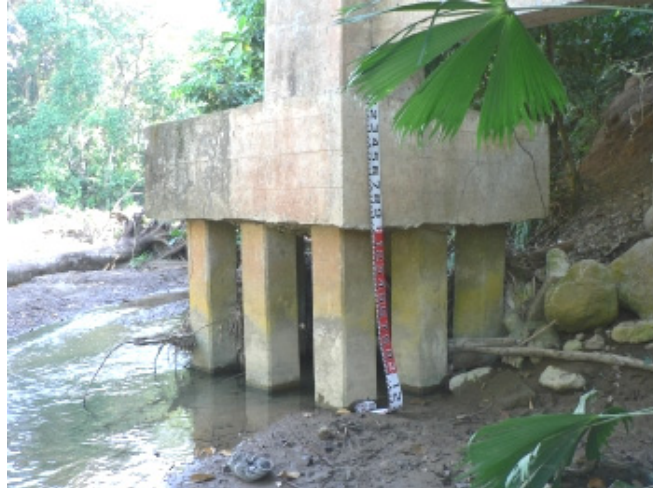
Figura 6-42 Socavación en la fundación (grado 5)
