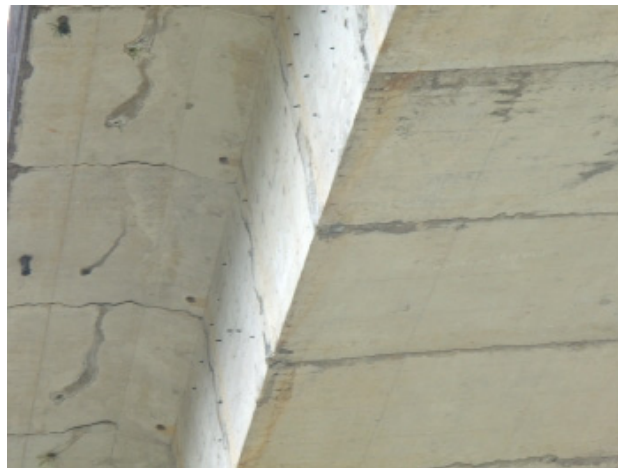
Figura 6-29 Fisuras del concreto en las juntas de construcción
