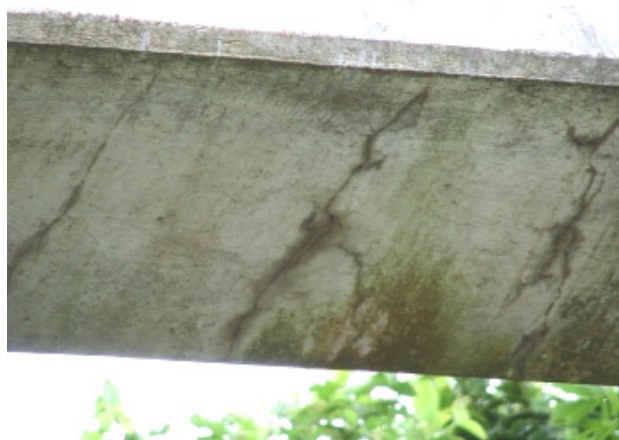
Figura 6-28 Grietas en una dirección (debido a flexión en la viga)
