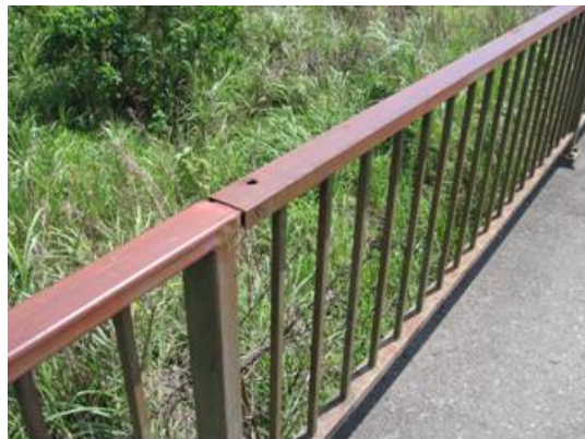
Figura 6-7 Corrosión en la baranda de acero (grado 3)
