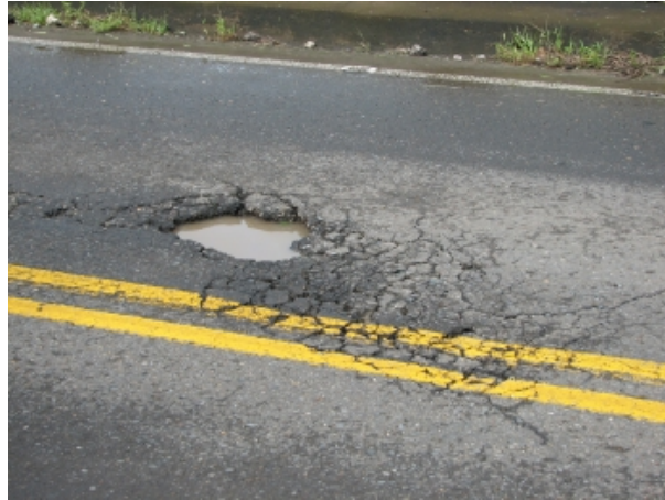
Figura 6-3 Baches en el pavimento (grado 2)
