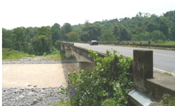
Figura 6-8 Falta baranda de acero (grado 5)
