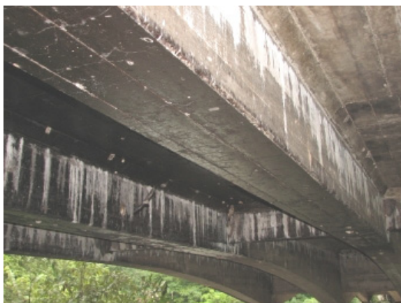
Figura 6-32 Eflorescencia en la viga principal (grado 4)
