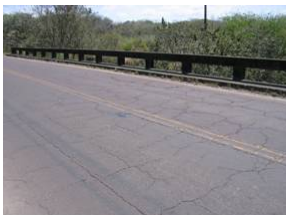
Figura 6-2 Grietas en el pavimento (grado 4)
