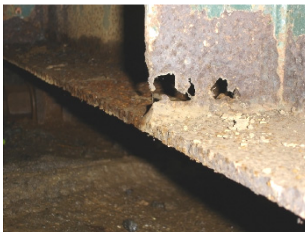
Figura 6-24 Corrosión del atiesador vertical (grado 5)
