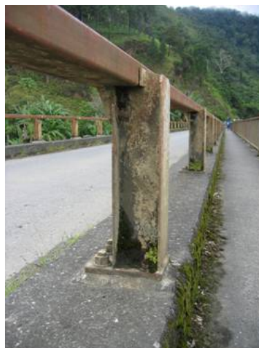
Figura 6-6 Oxidación (baranda de acero)
