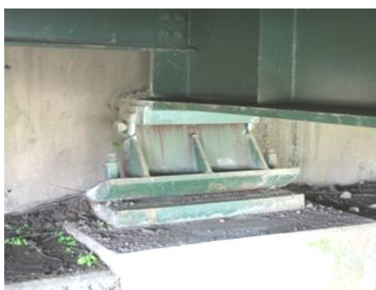
Figura 6-36 Inclinación del apoyo (grado 5)
