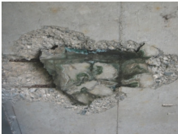
Figura 6-17 Nidos de piedra en la losa de concreto
