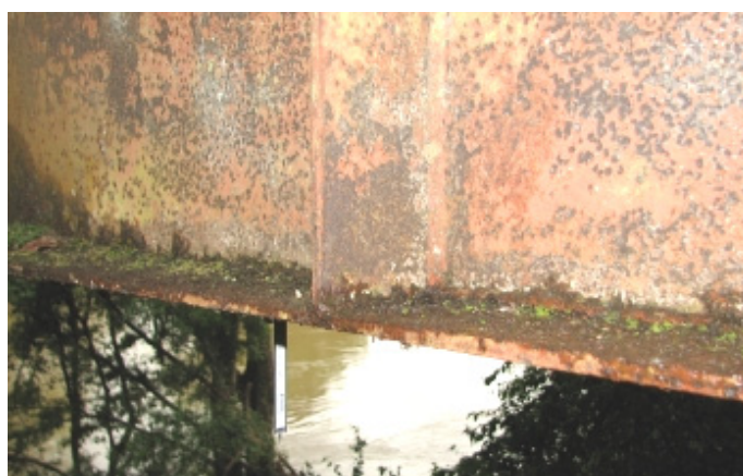
Figura 6-20 Oxidación en la viga principal
