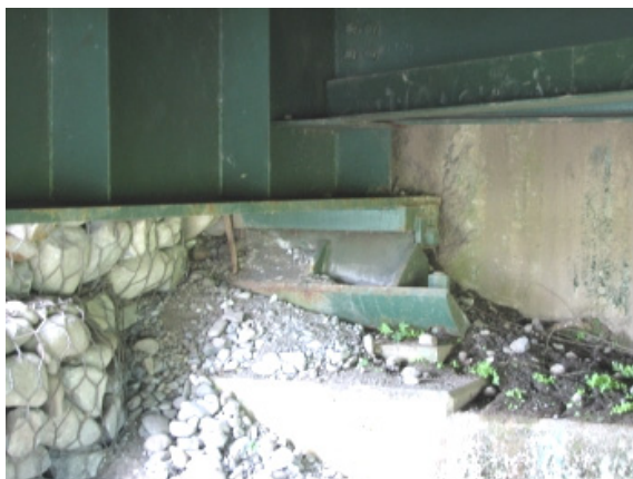
Figura 6-35 Deformación del apoyo (grado 5)
