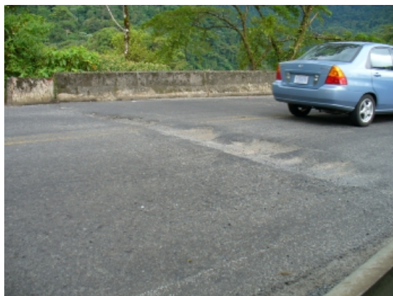
Figura 6-1 Ondulaciones en el pavimento
