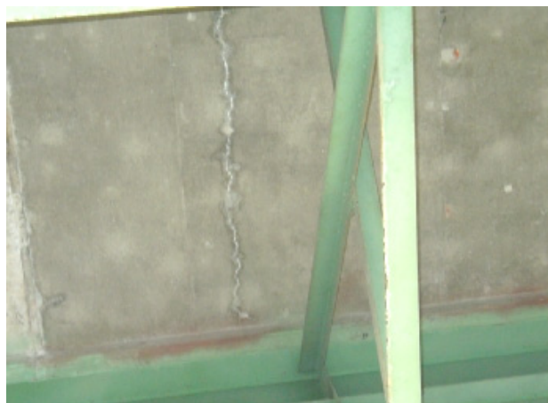
Figura 6-14 Grieta en una dirección en la losa
