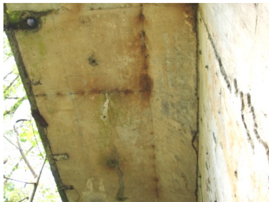
Figura 6-30 Oxidación en el acero de refuerzo.
