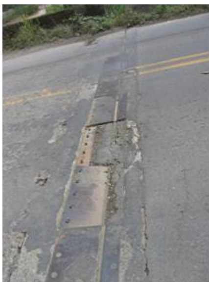
Figura 6-11 Faltante o deformación de las juntas de expansión (grado 5)
