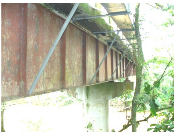
Figura 6-26 Decoloración de la viga principal
