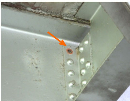
Figura 6-21 Pérdida de pernos
