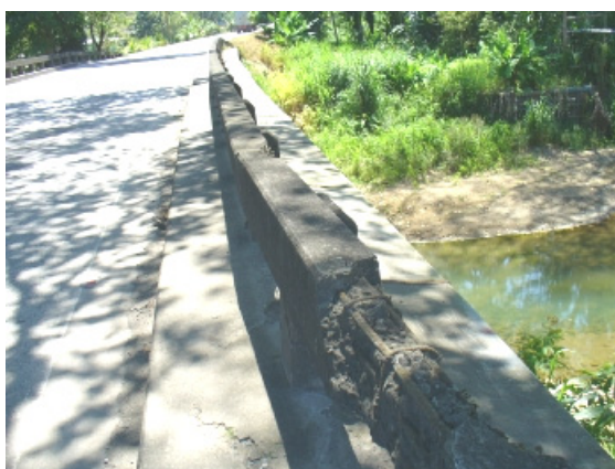
Figura 6-9 Acero de refuerzo expuesto (baranda de concreto)
