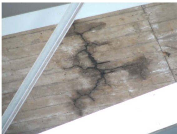
Figura 6-15 Grietas en dos direcciones
