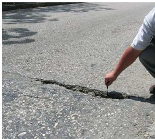
Figura 6-4 Sobrecapas en el pavimento (grado 5)
