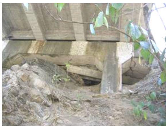
Figura 6-39 Colapso de la protección enfrente del bastión (Grado 5)
