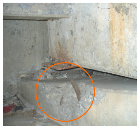
Figura 6-34 Pernos de anclaje cortados
