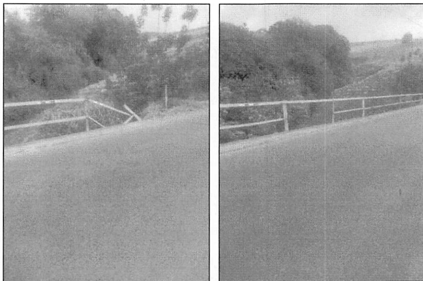
Imágenes 5 y 6. Deficiencias de las barandas del puente.
