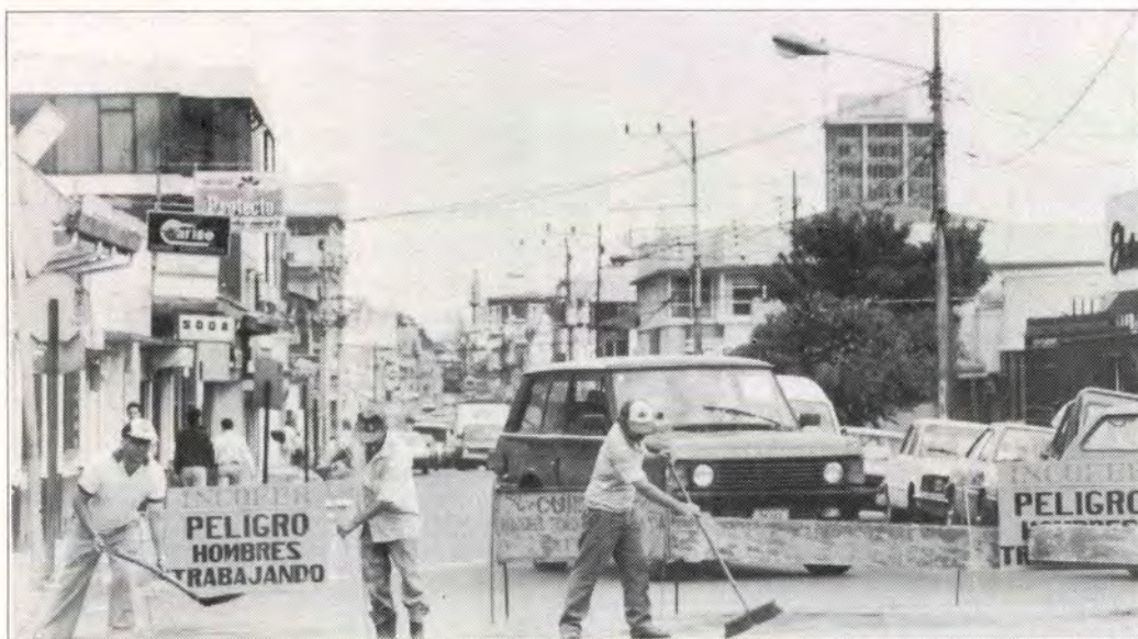
Durante 1992 se iniciaron los trabajos de reparación de los principales pasos a nivel en la capital.
