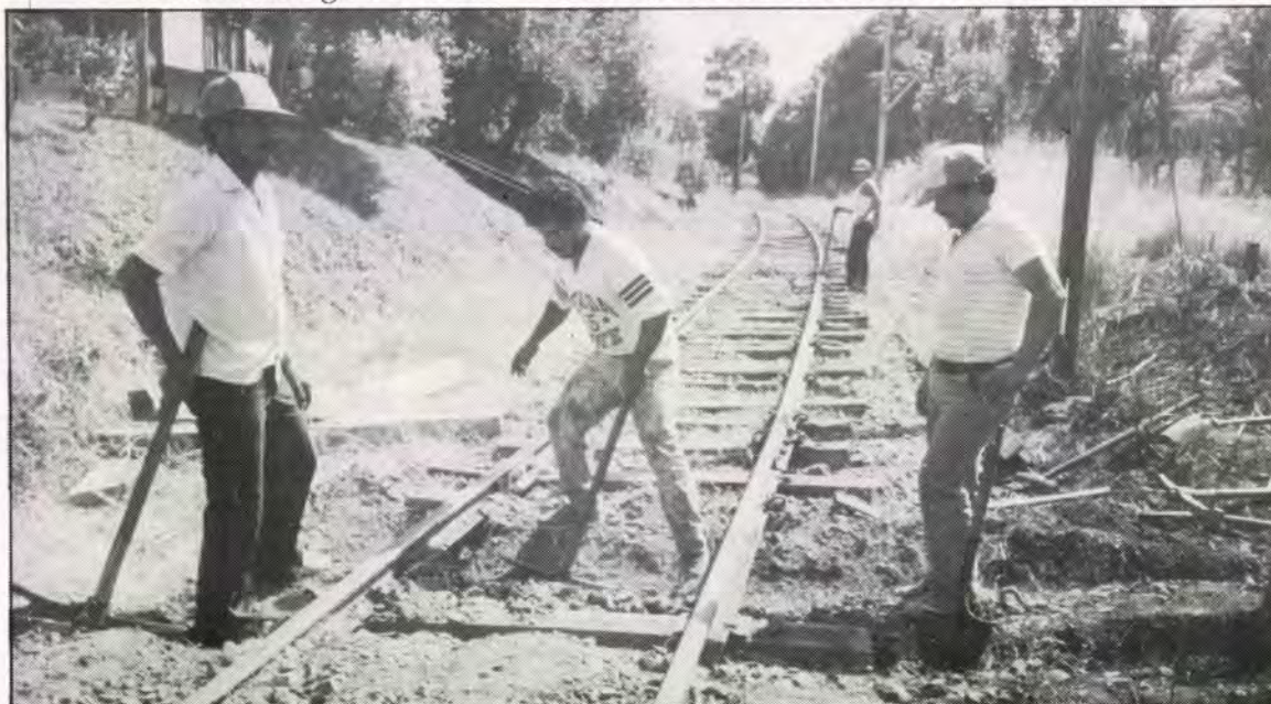
Con fondos propios el INCOFER ha reparado gran parte de la vía.
