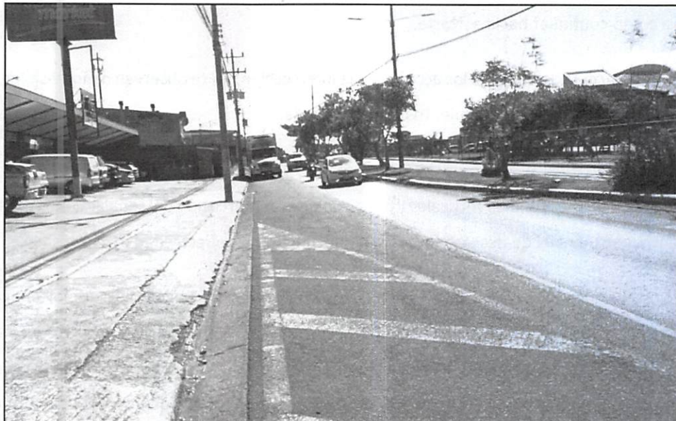
Figura 3 Acceso Este Boulevard El Molino, estado de la demarcación de horizontal de la calzada y la transición de dos carriles a un carril vehicular próxima a la intersección, vista de Oeste-Este.
