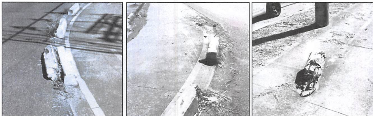
Figura 4 Estado de separadores de concreto de la ciclovía en mal estado, generado un alto riesgo de accidentes a los conductores y usuarios de la ciclovía, en la intersección con el Boulevard El Molino y Diagonal 18.
