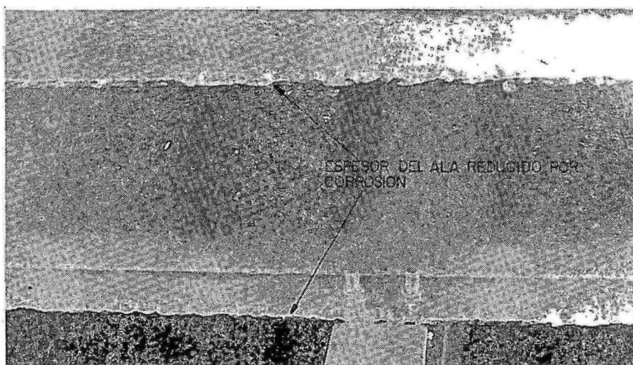
Fig. 57 Mantenimiento inadecuado Puente sobre el Rio Jabillos Ruta 142
