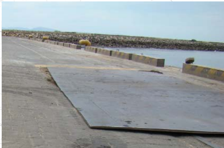
Fotografía contenida en el informe de Camacho y Mora Ingenieros para SPC
