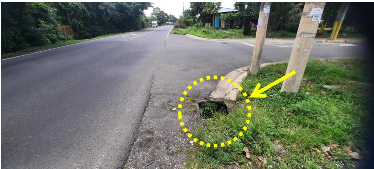
Figura 4 Alcantarilla sin tapa o rejilla esquina este de intersección Ruta Nacional N.° 124 con calle Las Ciruelas en San Antonio, Alajuela. Fuente: Propia.
