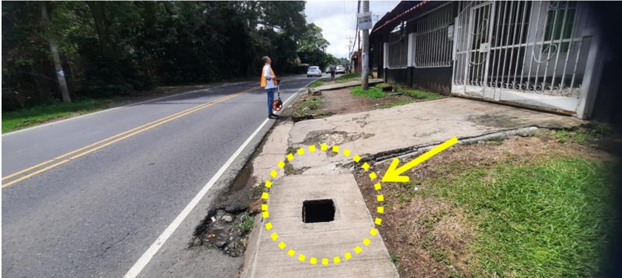
Figura 5 Alcantarilla sin tapa o rejilla en acera hacia el este de intersección Ruta Nacional N. ° 124 con calle Las Ciruelas en San Antonio, Alajuela. Fuente: Propia.
