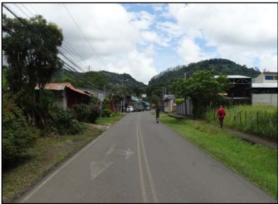
Figura N° 3 Señalamiento borroso, tramos sin acera
