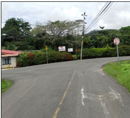
Figura N° 5 Señalamiento borroso ruta cantonal
