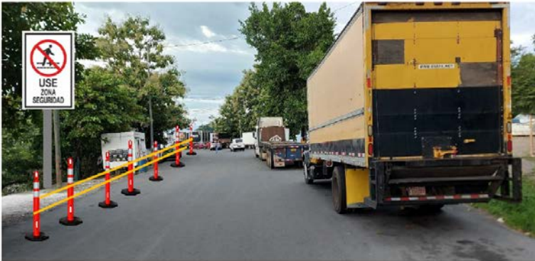
Figura 7. Canalización para el tránsito de peatones Fuente: (Villalobos, 2022)
