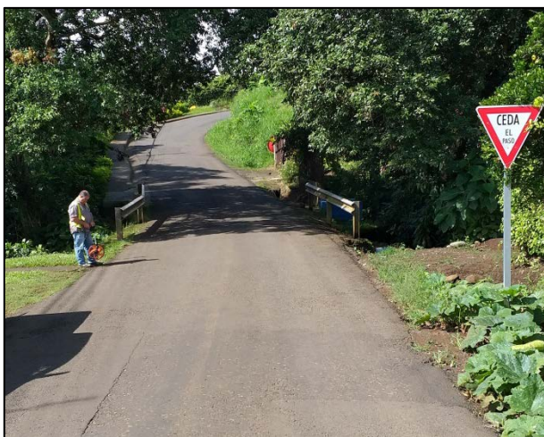
Figura N° 2 Puente angosto existente, sentido norte – sur, señalización vial existente.
