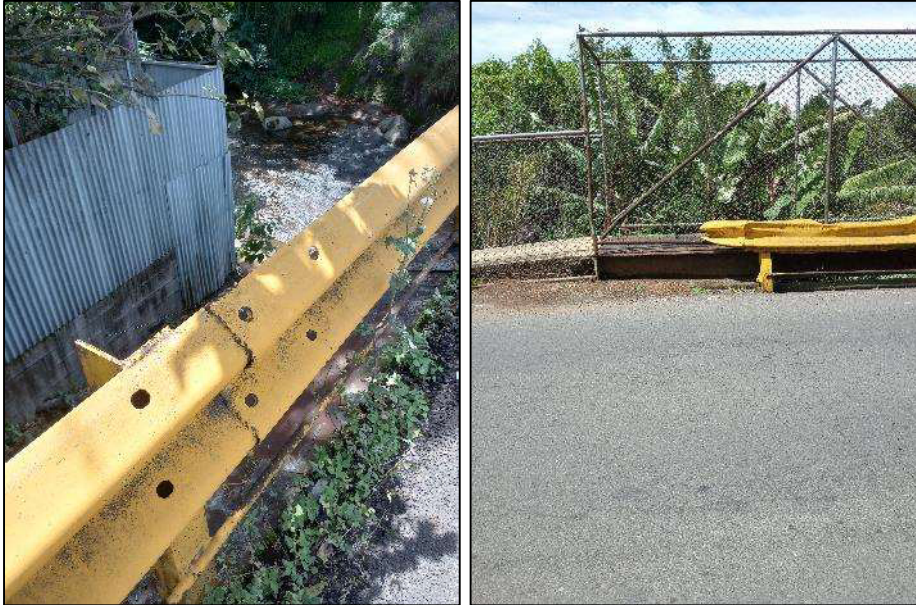
Imágenes 5 y 6. Deficiencias de las barreras del puente.
