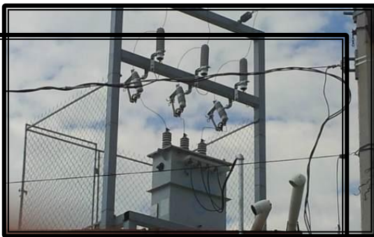
Mantenimiento de subestaciones
