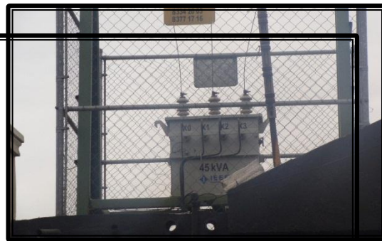
Mantenimiento de subestaciones
