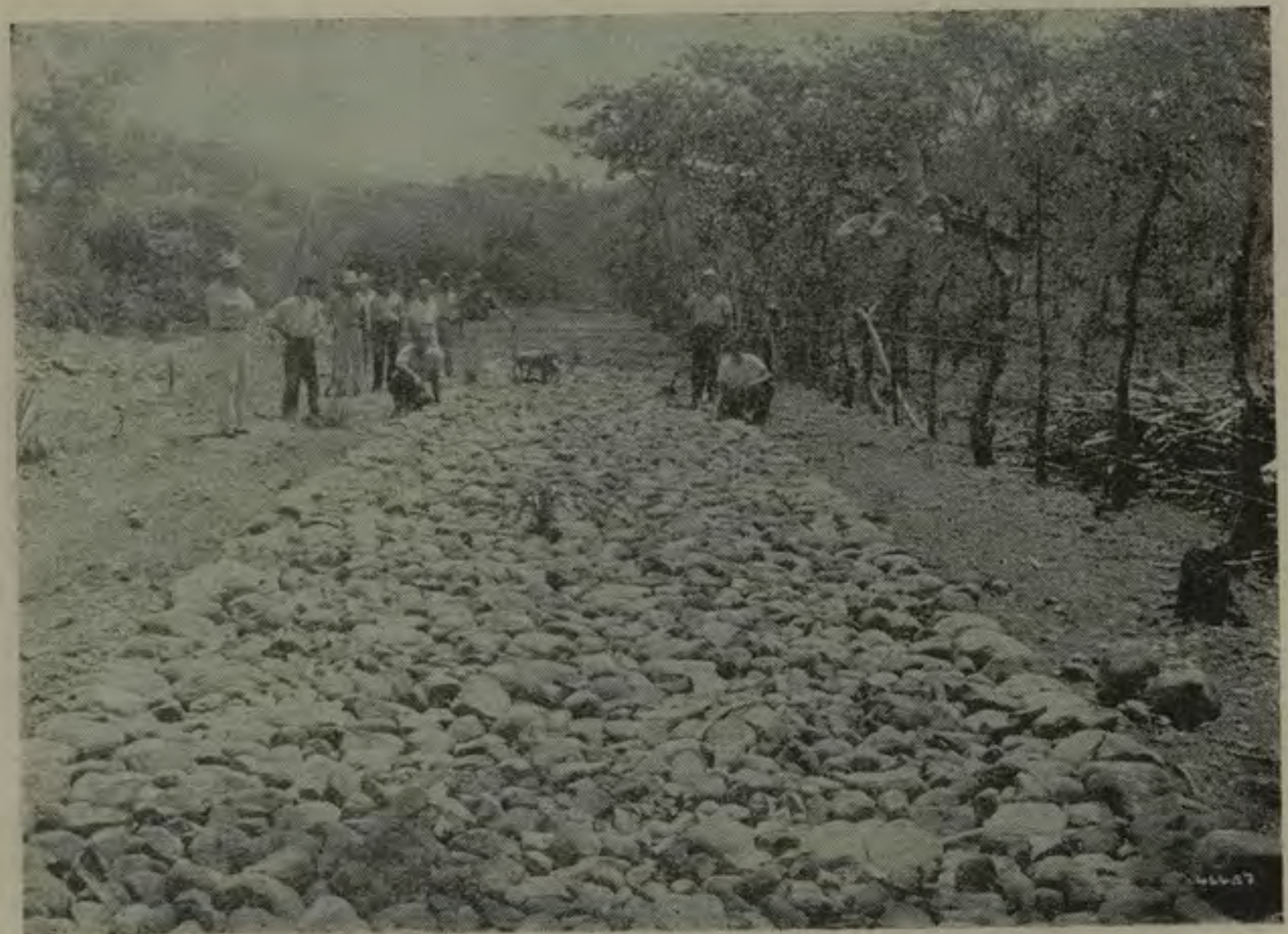
Trabajos realizados en la carretera de Guatuso, en San Miguel de Desamparados.
