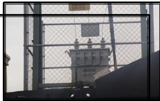
Mantenimiento de subestaciones
