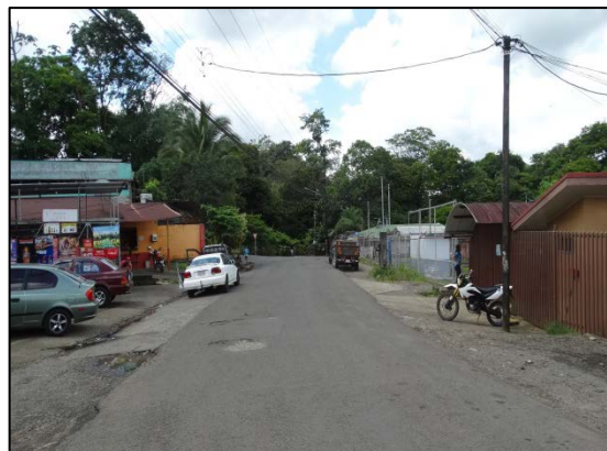
Figura N° 3. Asfalto con grietas y baches
