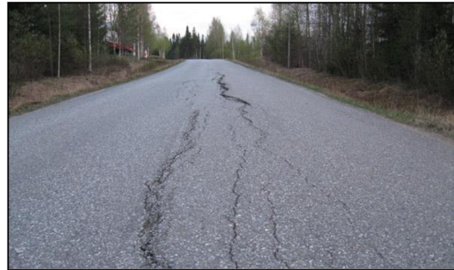
Figura 2.25 Imagen del nivel de severidad alto asociados a Hinchamiento
