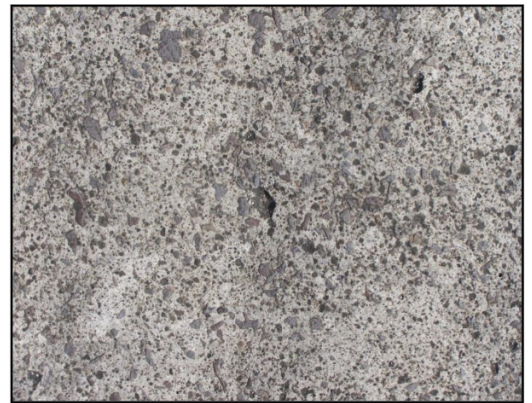
Figura 2.56 Imagen asociada a Desprendimiento de Agregados
