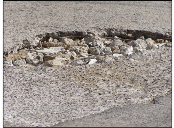
Figura 2.71 Caso Especial, Huecos en Pavimento Rígido.
