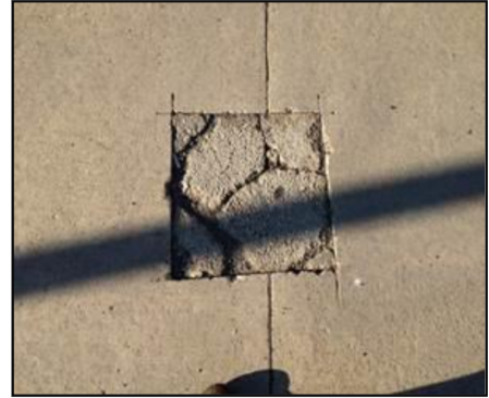
Figura 2.69 Imágenes del nivel de severidad alta asociado a Baches menores a 0,5 m 2
