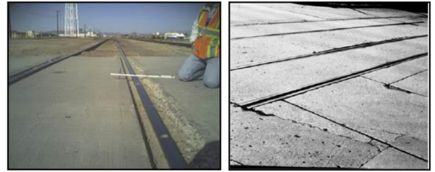
Figura 2.70 Imágenes de los niveles de severidad asociados a Cruce de Línea Férrea
