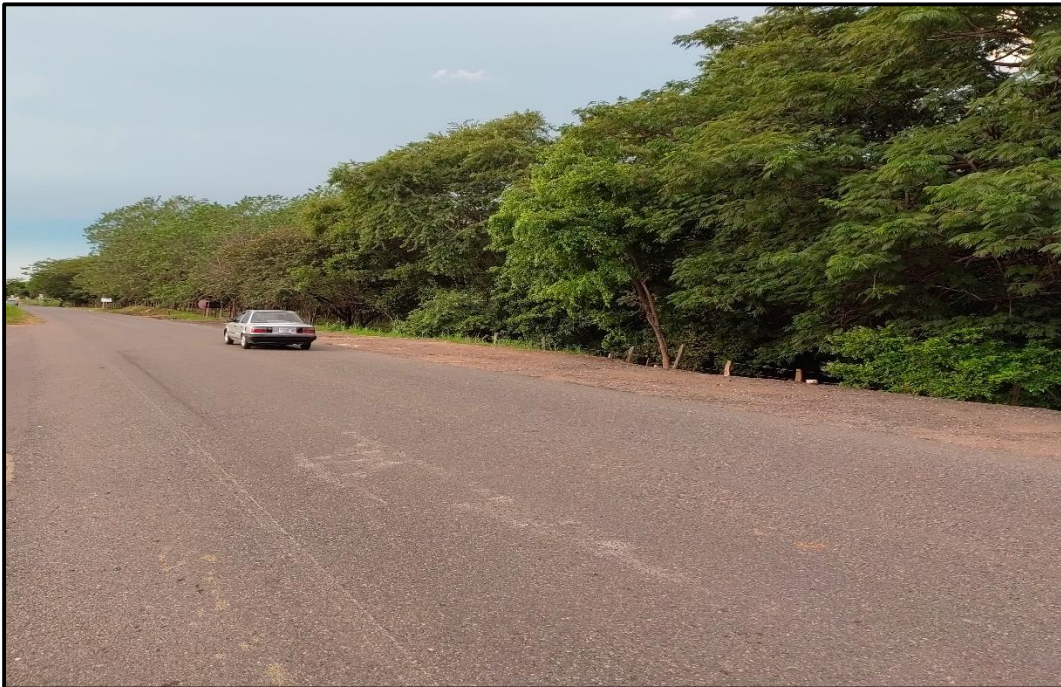
Imagen N° 2. Tramo de Ruta Nacional N° 6 sin demarcación.
