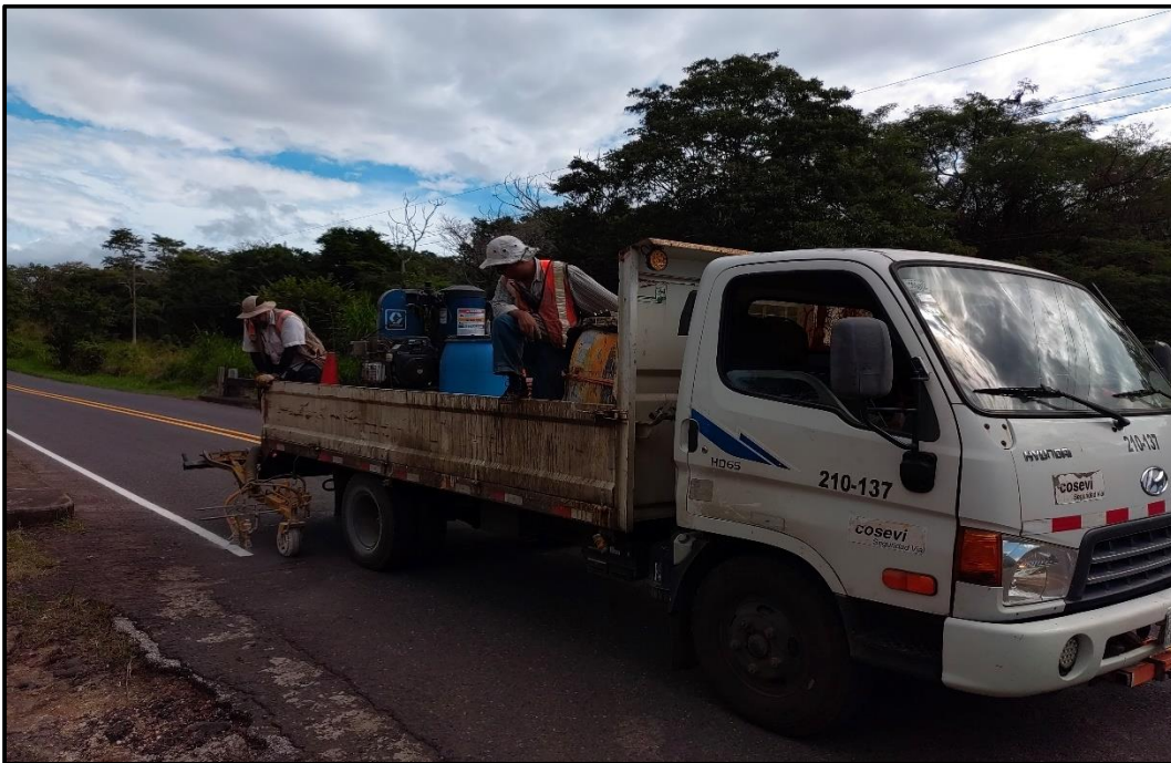
Imagen N° 6. Demarcación de línea de borde blanca.
