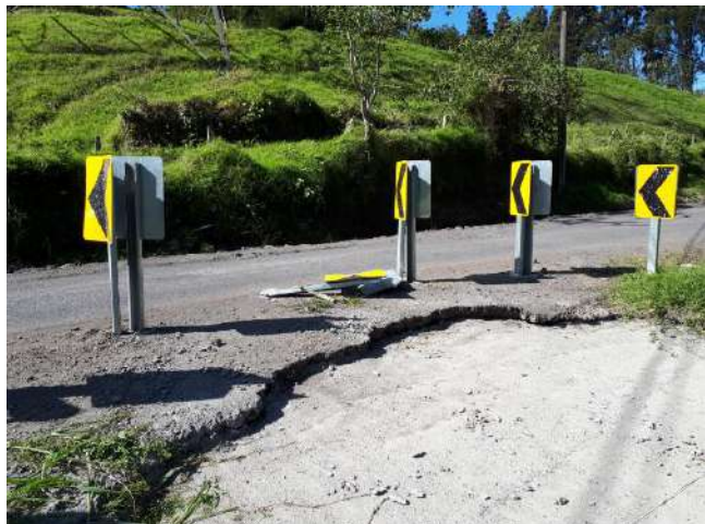
Fotografía 1: socavación de la ruta.
