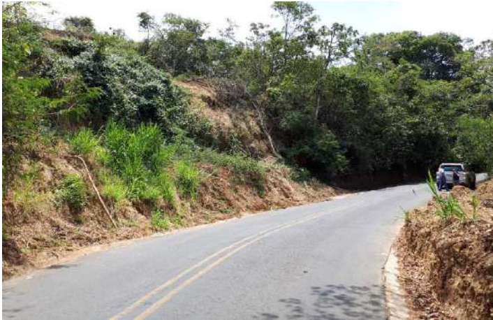
Fotografía 1: vista parcial del material deslizado con obstrucción de caños.
