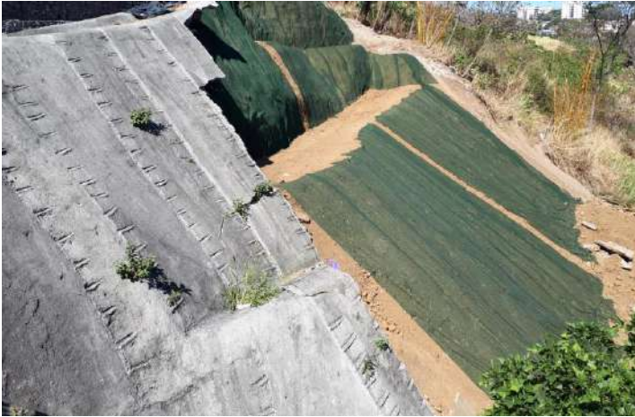
Fotografía 1: área del derrumbe.
