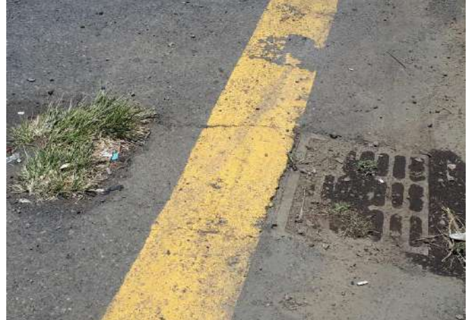
Fotografía 2: obstrucción de tragantes.
