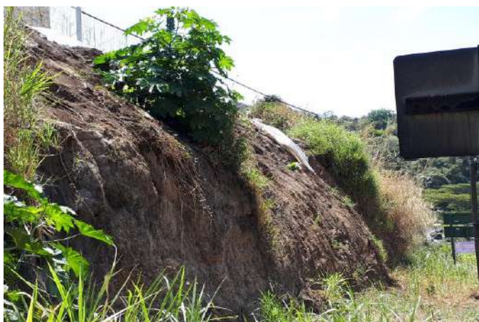
Fotografía 1: área de desprendimiento de material.
