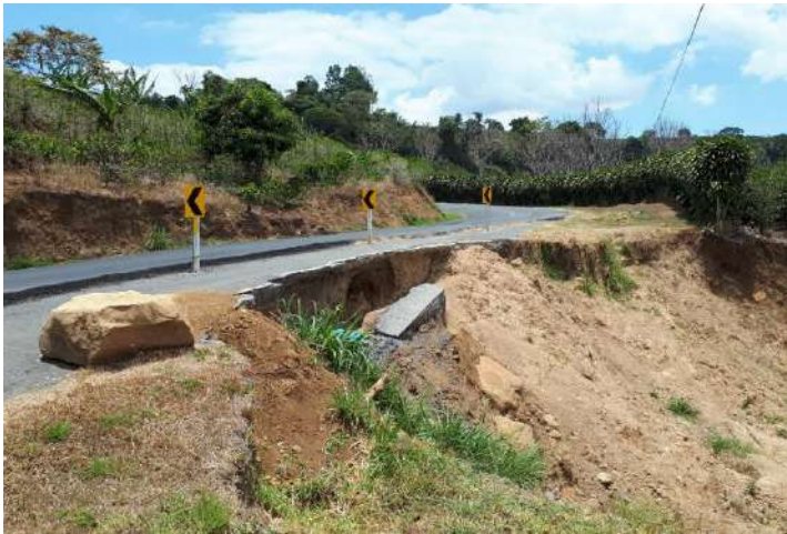
Fotografía 1: vista general del deslizamiento
