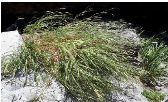
Fotografía 3: vegetación sobre nuevas los nuevos elementos construidos.
