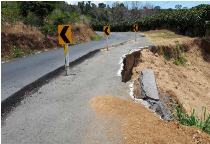
Fotografía 3: corona de deslizamiento sobre la calzada.
