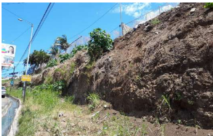
Fotografía 3: vista parcial del talud que podría generar otros evento similares.
