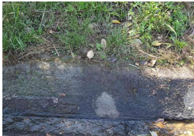
Fotografía 2: escurrimiento de aguas de origen desconocido.
