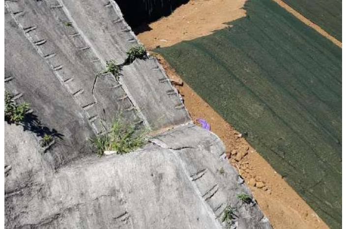
Fotografía 2: deterioro progresivo del revestimiento.
