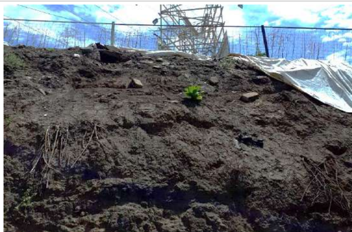
Fotografía 2: área sin la protección erosiva correspondiente.
