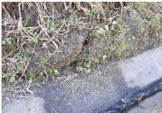
Fotografía 3: afloramientos de agua sobre la ladera.
