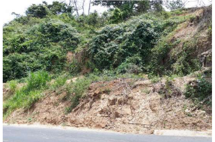
Fotografía 2: material deslizado pendiente arriba.
