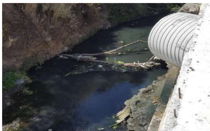
Fotografía 4: aguas pluviales caen sobre la base de la nueva estructura.
