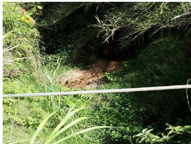
Fotografía 4: obstrucción de alcantarilla aguas abajo.
