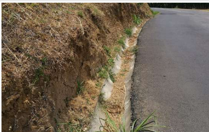
Fotografía 5: cordón de caño existente con acumulación de escombros.
