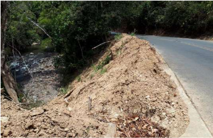
Fotografía 3: material deslizado pendiente abajo con obstrucción de cordón de caño.
