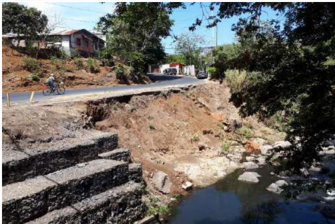
Fotografía 1: área del derrumbe y socavación del cordón de caño.
