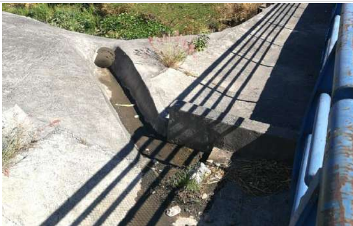
Fotografía 5: detalle del sistema de drenaje con desfogue anexo a la ladera con afectación.
