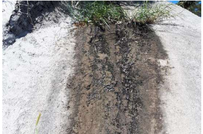
Fotografía 4: infiltración de aguas en el revestimiento.
