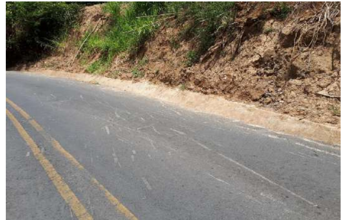
Fotografía 4: marcas en la calzada de la maquinaria, intervención por remoción del derrumbe.
