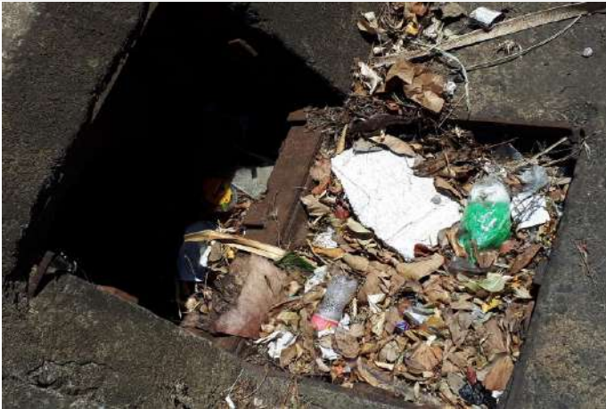
Fotografía 3: obstrucción de tragantes.
