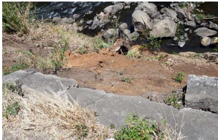
Fotografía 4: vista superior del derrumbe.
