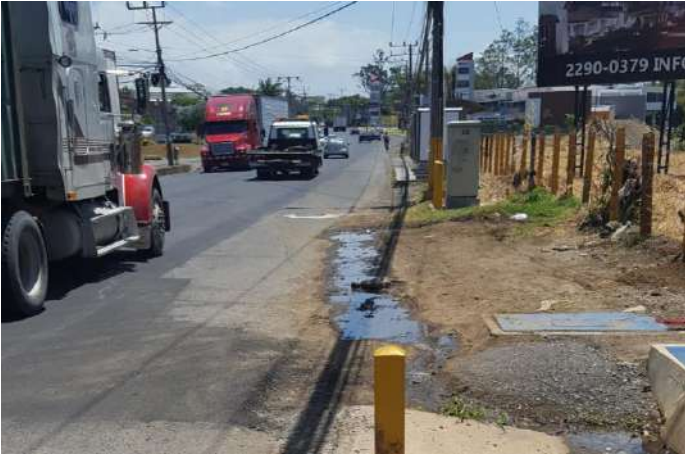
Fotografía 1: faltante de cunetas y caños.
