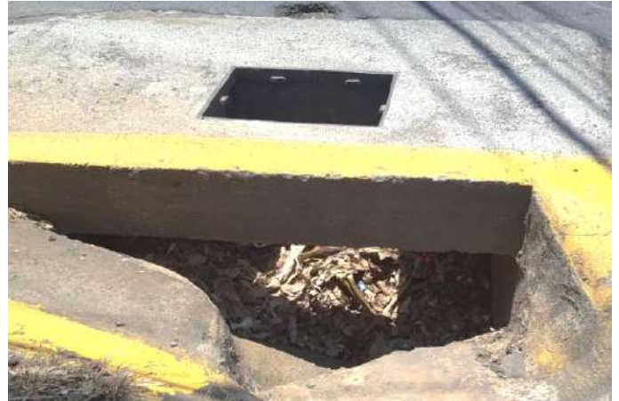
Fotografía 4: obstrucción de alcantarillas.
