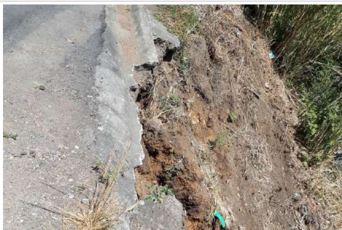
Fotografía 3: pérdida del cordón de caño.
