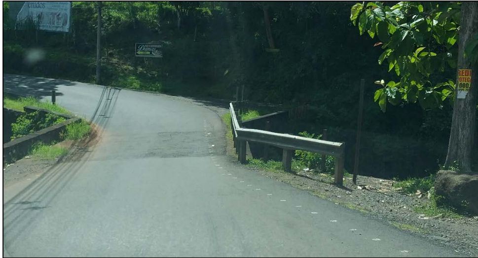
Figura 10. Puente angosto sin señalamiento
