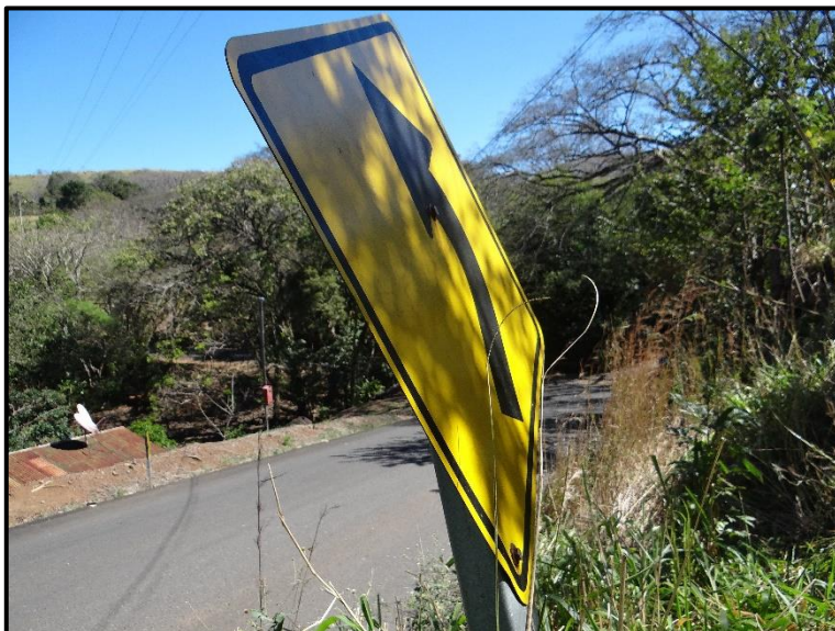
Imagen N° 6. Señal en mal estado en la zona de estudio.
