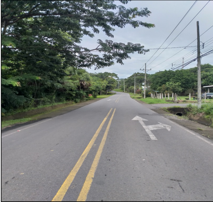
Figura N° 2 Zona en estudio, señalamiento horizontal borroso
