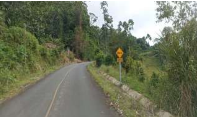
Figura 4. Señalamiento superficie irregular.
