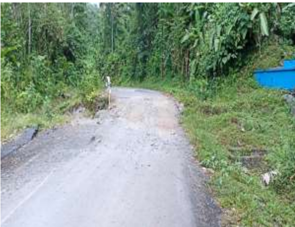
Figura 2. Deslizamiento en la vía
