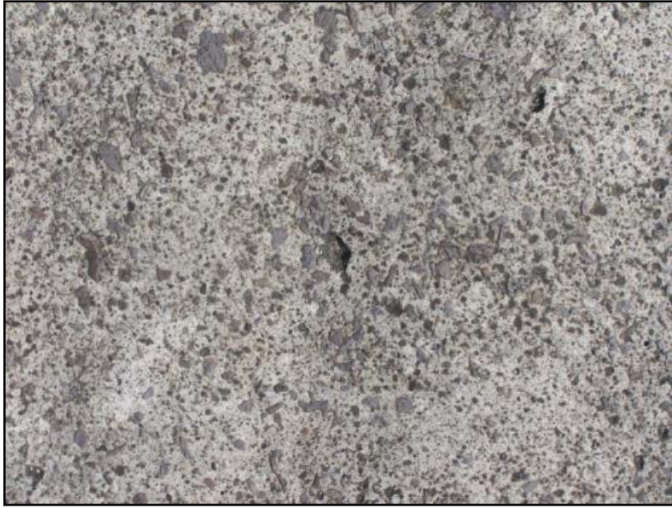
Figura 4.57 Imagen asociada a Desprendimiento de Agregados
