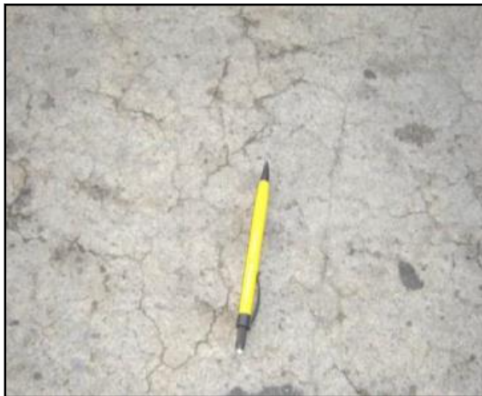
Figura 4.46 Imagen asociada a la Grieta por Contracción
