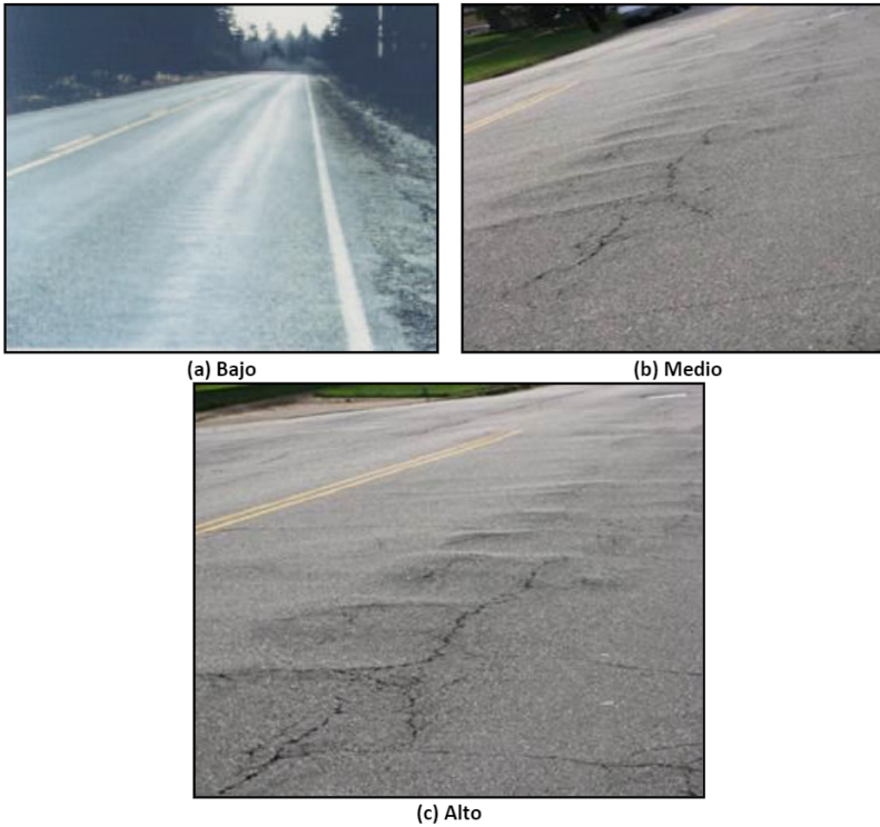
Figura 4.21 Imágenes de los niveles de severidad asociados a Corrugación
