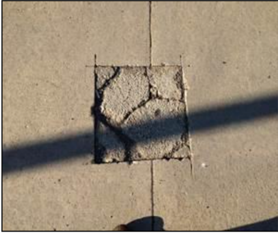
Figura 4.70 Imágenes del nivel de severidad alta asociado a Baches menores a 0,5 m 2
