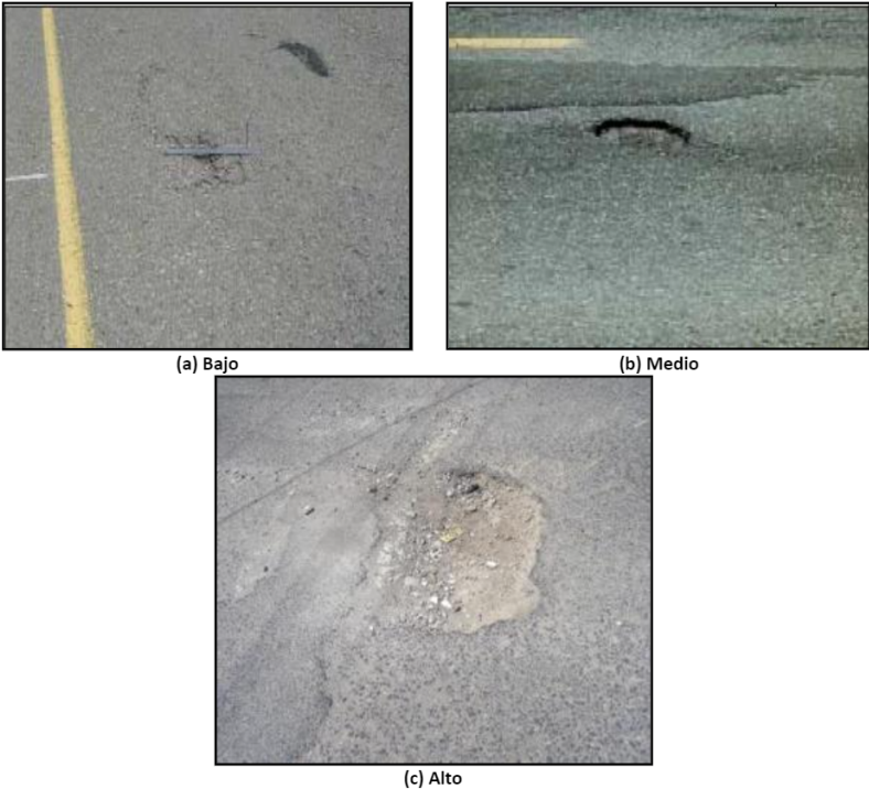
Figura 4.37 Imágenes de los niveles de severidad asociados a los Huecos
