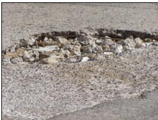
Figura 4.72 Caso Especial, Huecos en Pavimento Rígido.
