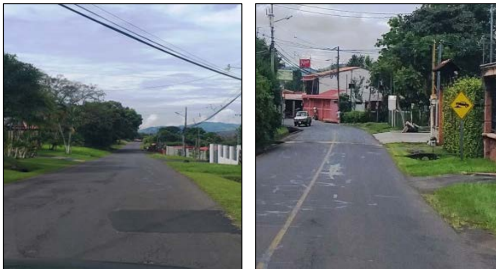
Figura N°3. Señalamiento horizontal borroso o inexistente, reductor de velocidad frente al Ebais.
