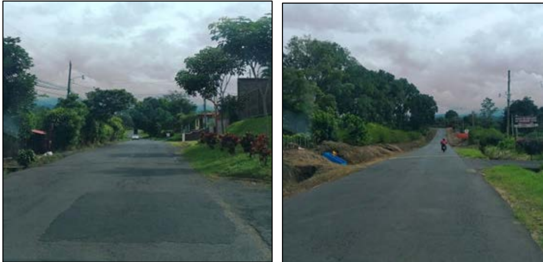
Figura N°2. Carpeta con baches, márgenes en zona verde, intersección
