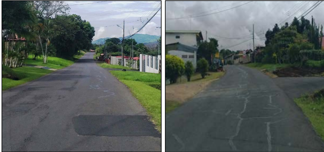
Figura N°4. Superficie de rodamiento con baches, márgenes con caño y zona verde
