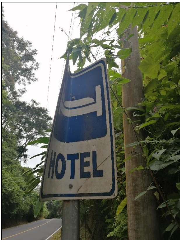
Figura 3. Señal vertical dañada ruta nacional N.º 137, Hotel AmaTierra, Turrubares, San José. Fuente: Propia.
